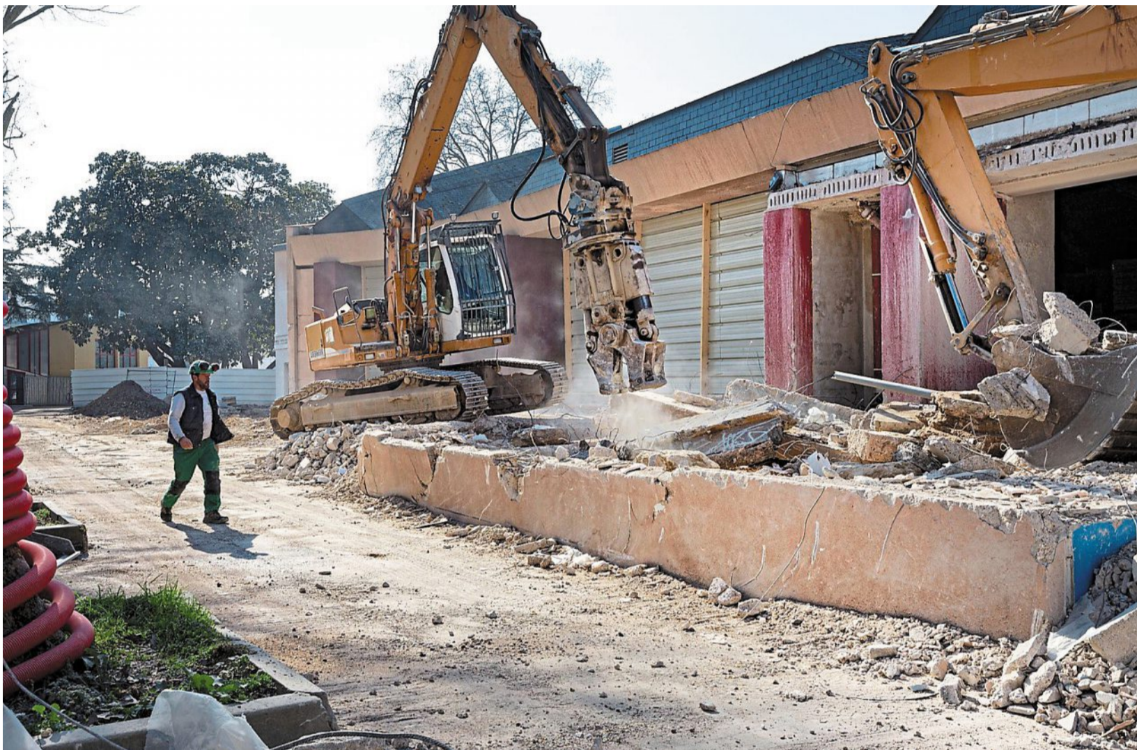
Angers, ancienne patinoire du Haras, lundi. L'entreprise de démolition E.B.M est à pied d'œuvre depuis une quinzaine de jours. En septembre 2022, on trouvera à cet endroit une salle de handball de niveau 1 ainsi qu'une salle de sport annexe.
